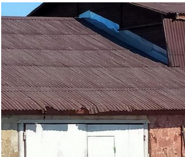
Разрушение свеса листов
