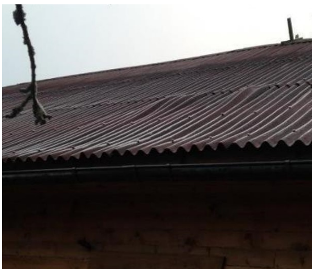
Провисание листов Ондулина из-за неправильно смонтированной обрешётки
